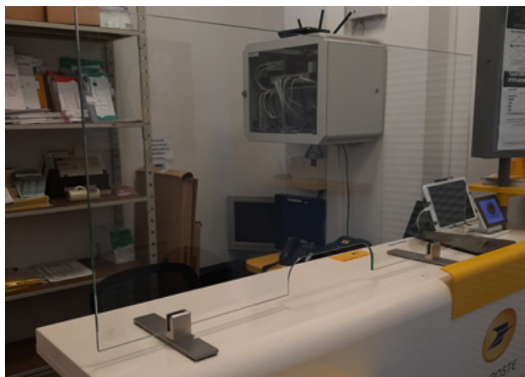
Installation de protection sanitaire au secrétariat de la mairie et à l'agence postale
